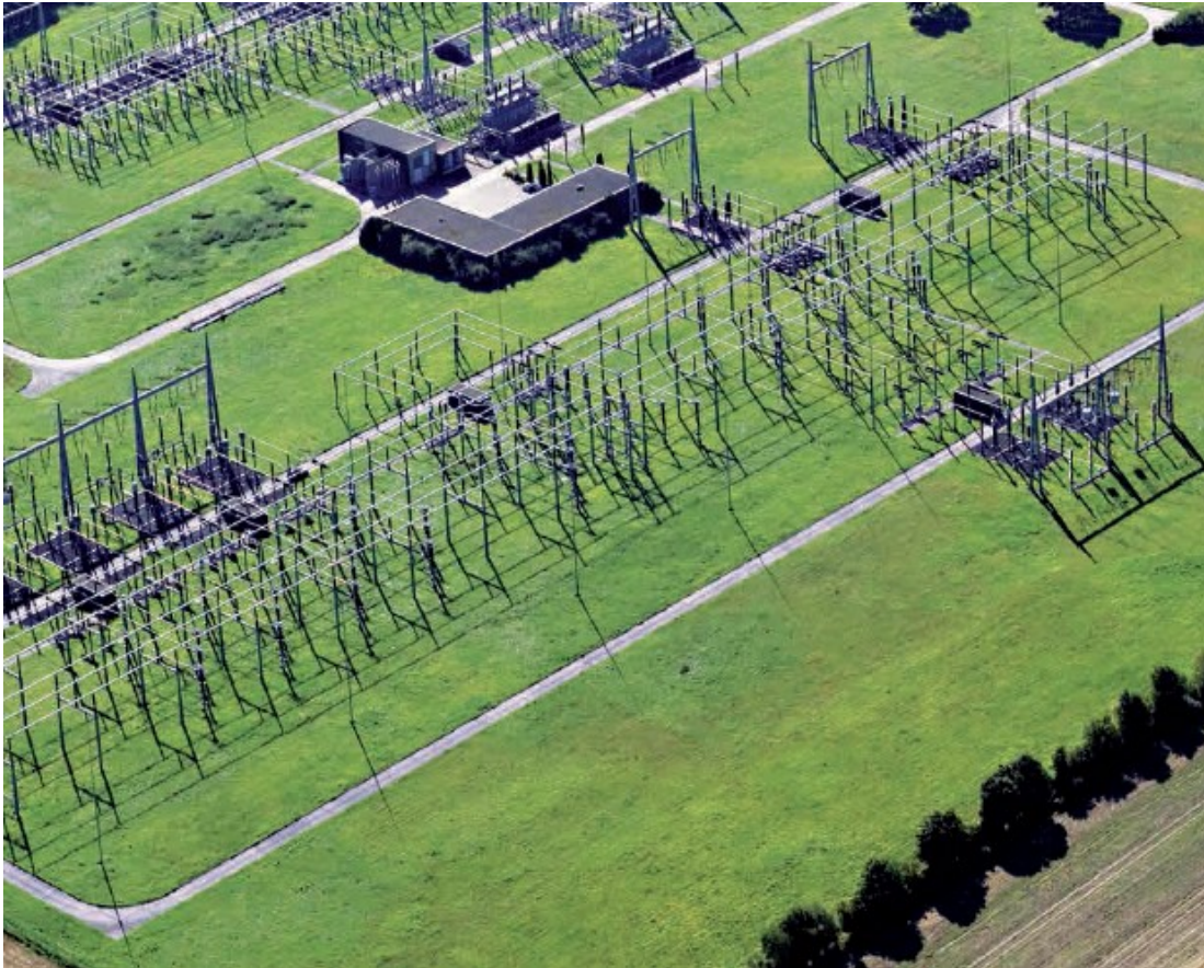
Abb. 8: Eingrünung eines Umspannwerks bzw. einer Schaltanlage
