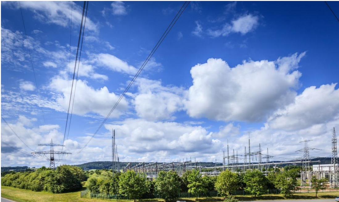
Abb. 8: Eingrünung eines Umspannwerks bzw. einer Schaltanlage
