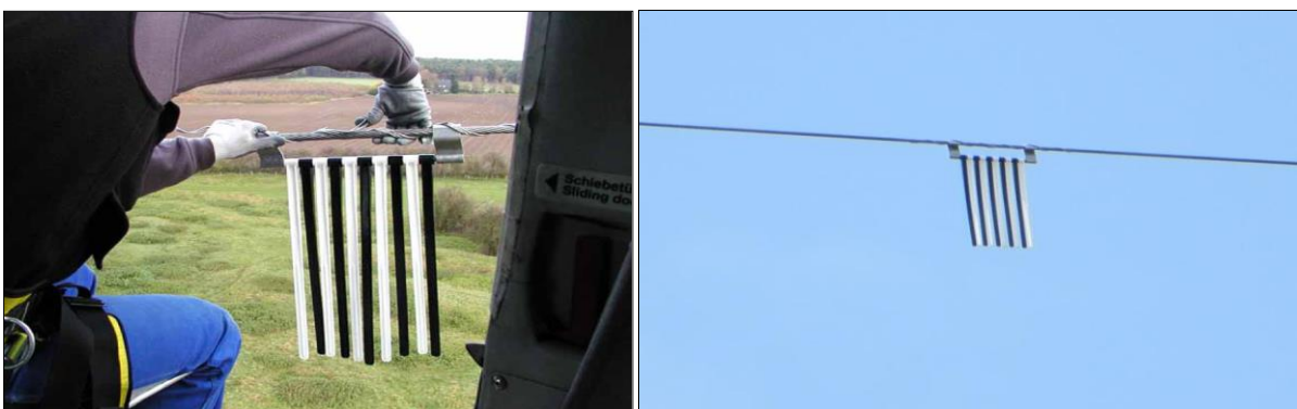
Abbildung 17: Vogelschutzmarker am Erdseil. Dem Stand der Technik entsprechende bewegliche, schwarz-weiße Lamellenmarker.
